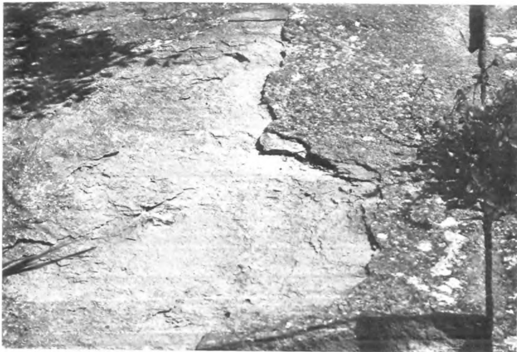
Tempio. Blocco in Pietra Serena interessato da spesse croste superficiali in parte già distaccate.
